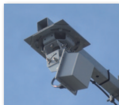
ITSスポット路側機(送受信部)
